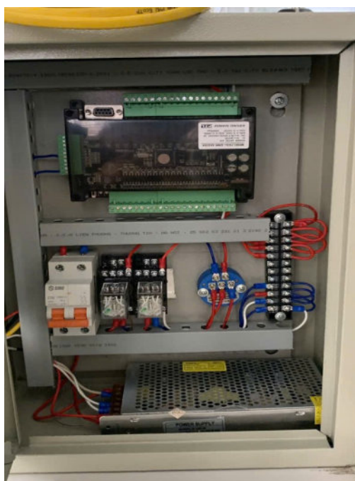
Hình 3. Hệ thống điều khiển
