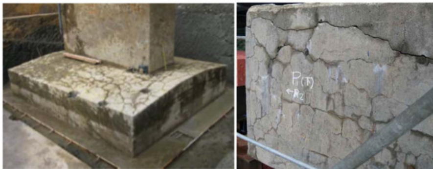
Hình 2. Hiện tượng nứt liên quan đến ASR trên các công trình cầu bê tông tại vùng Hokuriku, Nhật Bản [7]
