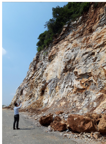
Hình 1. Mái dốc tại Km 19
