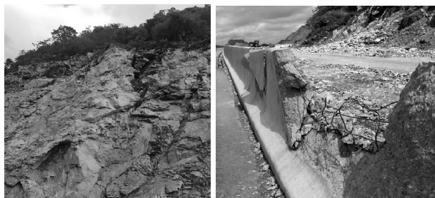
Hình 2. Đặc điểm khối đá tại mái dốc nơi xảy ra trượt lở (trái) và dải phân cách bằng bê tông bị hư hại do tác động của đá rơi (phải)
